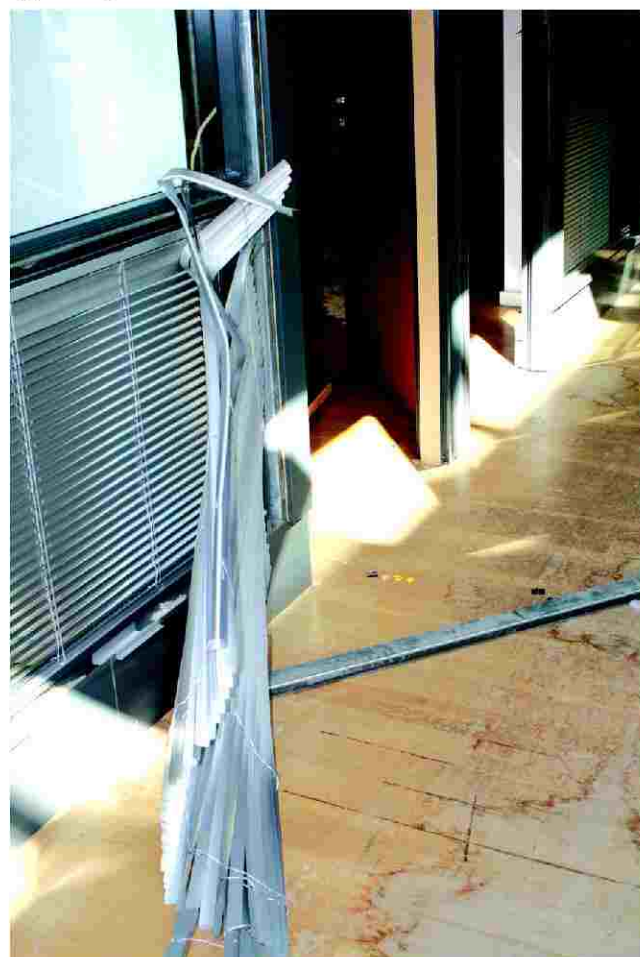
Equipamentos eléctricos e vidros partidos fazem parte do mesmo cenário degradante
